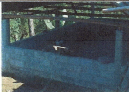
Foto 2: Vista donde se puede observar la necesidad de remozar los renglones de trabajo cubierta de techo, estructura de techo y canales de bajadas de agua.
