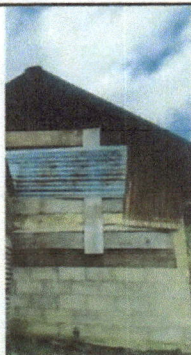
Foto 1: Vista de pared en donde es necesaria la rehabilitación de paredes.
